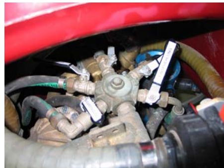
Abb. 12: Verteiler für Sonderfunktionen oberhalb der Pumpe.
